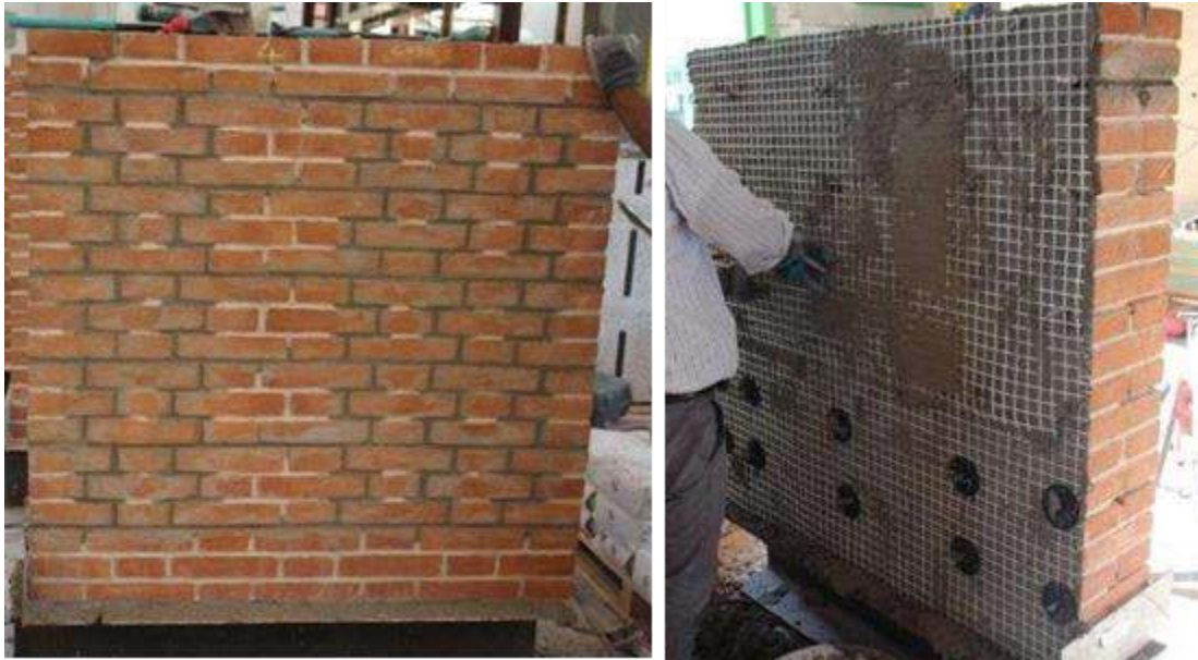
Figura 87: Fasi di applicazione del rinforzo per il pannello CD_2, lato A (sinistra) lato B (destra).
