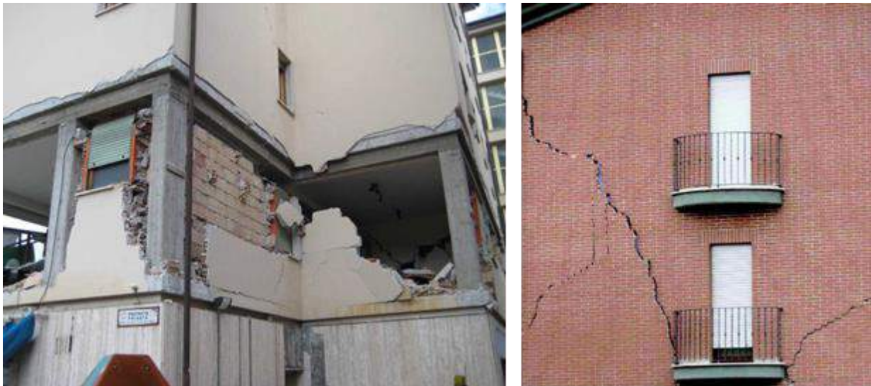
Immagine 18: Pareti di tamponamento danneggiate in seguito a un sisma.
