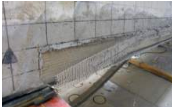
Figura 78: Rottura del rinforzo a matrice inorganica con tessuti in acciaio UHTSS.
