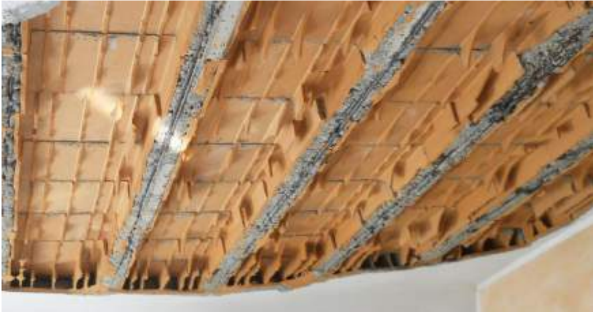
Immagine 14: Fenomeno sfondellamento solaio.
