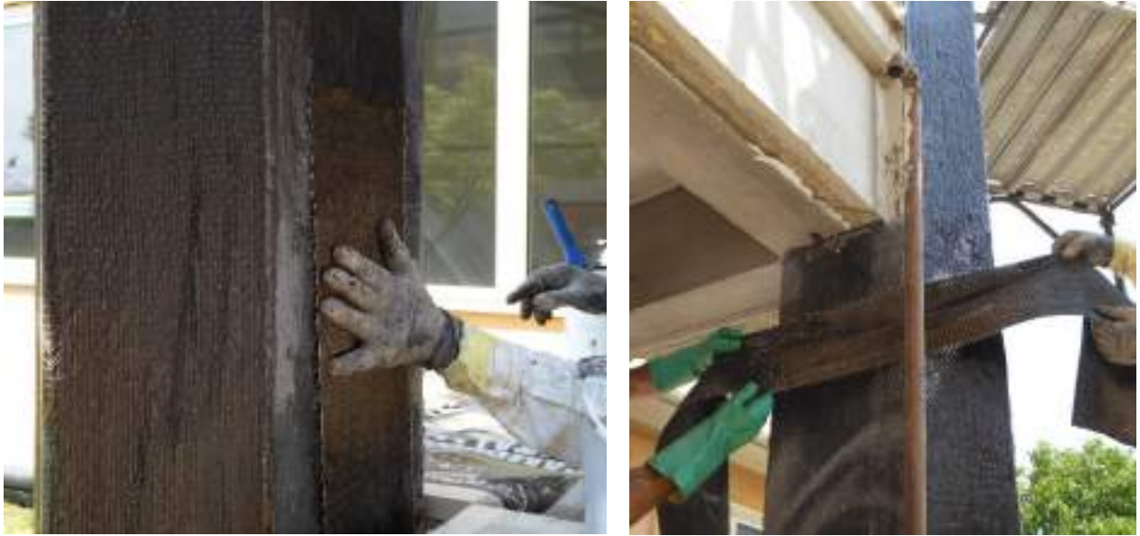
Immagine 2: Applicazione CFRP System su pilastri in c.a.
