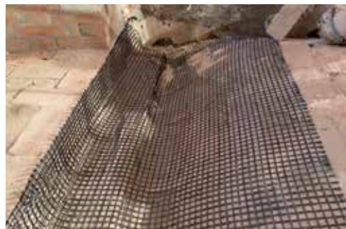
Cantiere Palazzo Chiarino (AQ) Rinforzo di volte con rete in carbonio C-NET, connettore CFIX e malta in calce naturale LIMECRETE.
