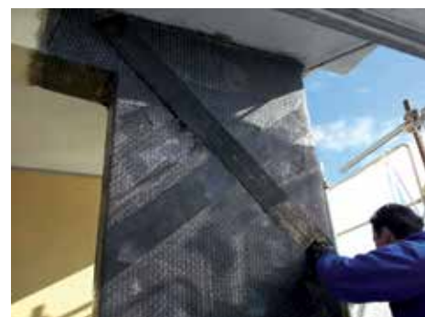
Rinforzo nodi c.a. con fibra di carbonio C-Sheet Monticchio (Aq) - Edificio privato
