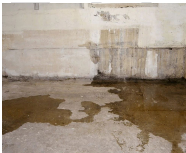
Infiltrazioni d'acqua nei locali interrati
